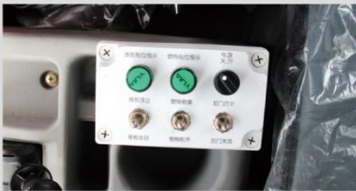
驾驶室内集中电控 ↑
